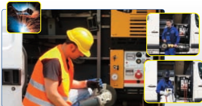
Utilizzo elettrico tri-mono fase e saldatura
